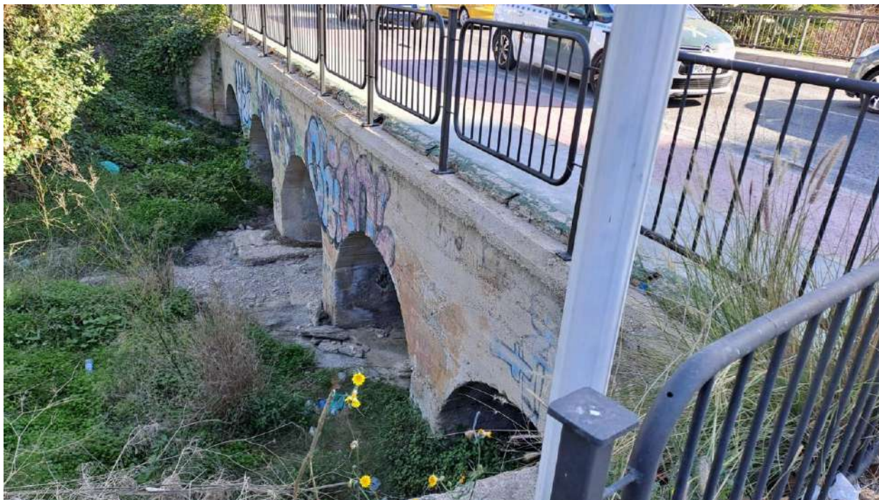
Imagen 1. Estado actual del puente que cruza el barranco de Lliriet.
